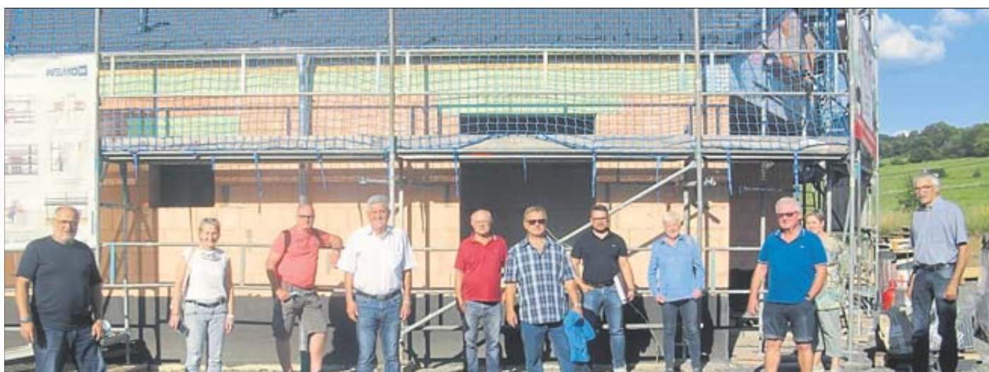
Hier ist etwas in Bewegung – die Mitglieder der SPD-Fraktion Schlüchtern mit denen des Ortsbeirats Gundhelm vor dem Rohbau des neuen Kindergartens. Foto: SPD-Fraktion Schlüchtern
